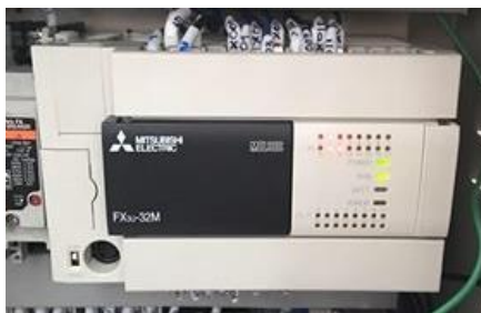
รูปที่ 1 PLC ที่นำมาใช้ควบคุมระบบของ Mitsubishi รุ่น Fx3u-32M
